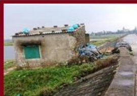
PHÁP LUẬT/ Phát hiện hơn 51.000 vụ vi phạm công trình thủy lợi
